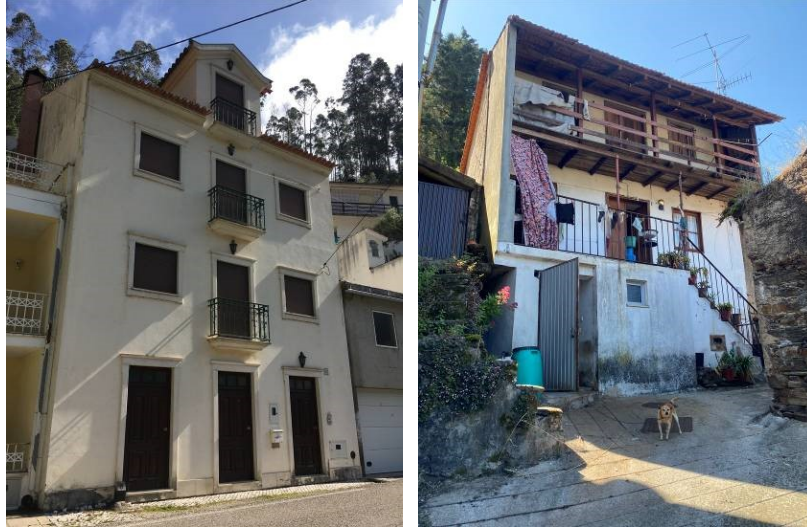
Figuras 23 e 24 – Edifício na ARU-FC – anomalias de Nível 3. (edifícios 011 e 107, identificados no Anexo I)
